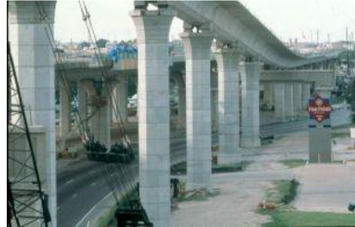
Fig. 8: Precast Piers ( www.fhwa.dot.gov )
