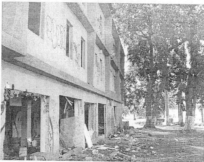
(1.6) Edificio abandonado cerca de la Estación Roosevelt Ave. Roosevelt
